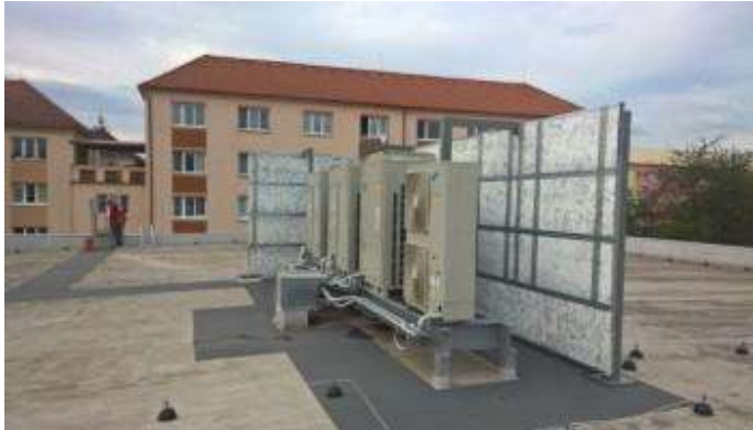
Odhlučnenie vonkajšej klimatizačnej jednotky
