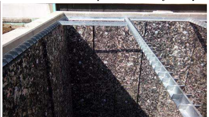
Nemocnica – odhlučnenie pre klimatizačné jednotky
