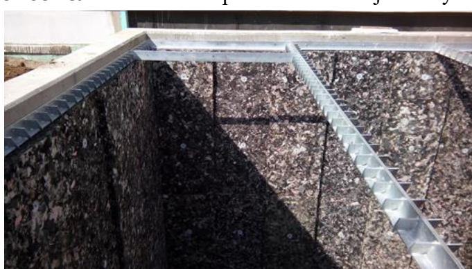
Nemocnica – odhlučnenie pre klimatizačné jednotky
