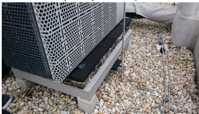
Uloženie tepel. čerpadla na obytného domu
